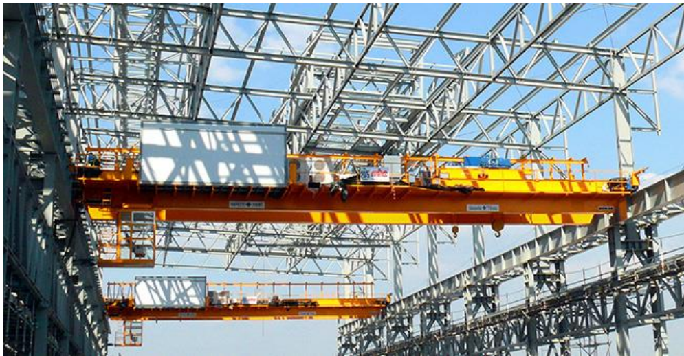
รูปที่ 9 การใช้งานผลิตภัณฑ์เหล็กโครงสร้างรูปพรรณรีดร้อน รูปตัวไอ (I-beam) สำหรับรางเลื่อนของเครนในโรงงานอุตสาหกรรม
